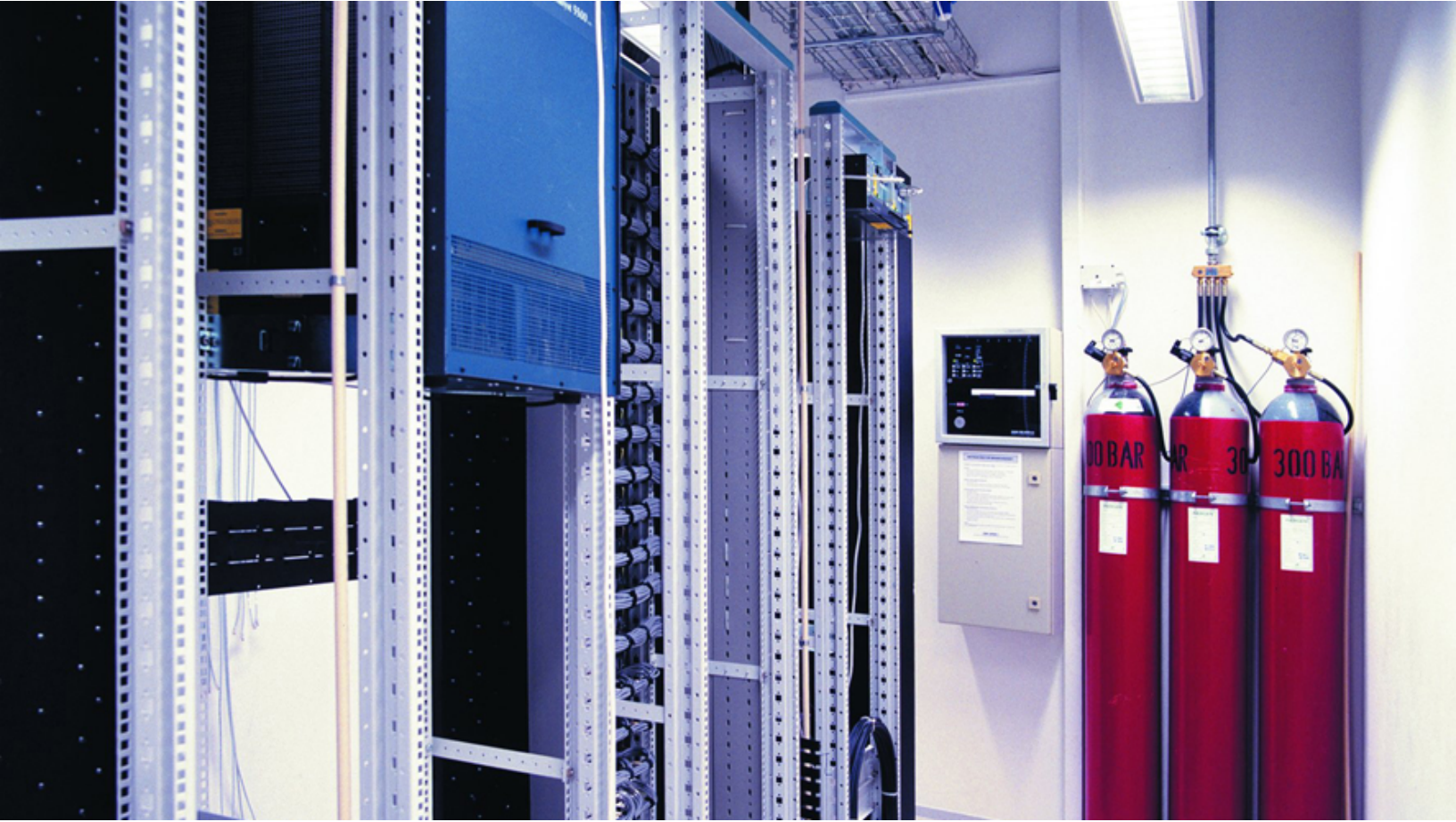
Ett gassläcksystem installerat i ett datorrum
